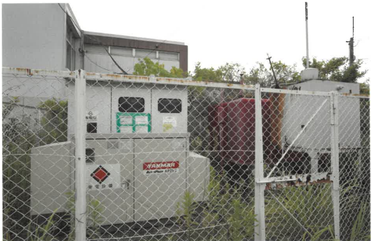
(写真④) 本件建物のキュービクル等(売却対象外PCB保管場所)
