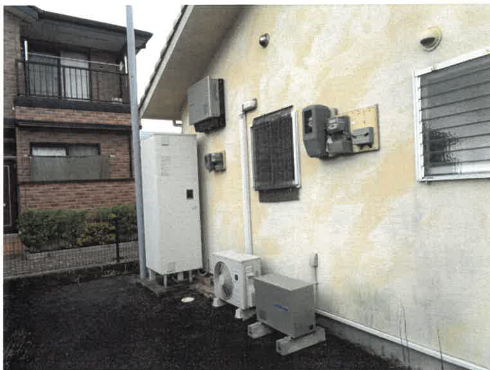
(写真5) 売却対象物件(従物)である私設ポール, 電気温水器及び蓄電池
