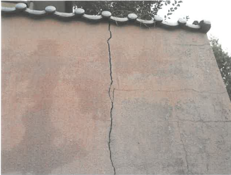
物件1・2 擁壁のクラック
