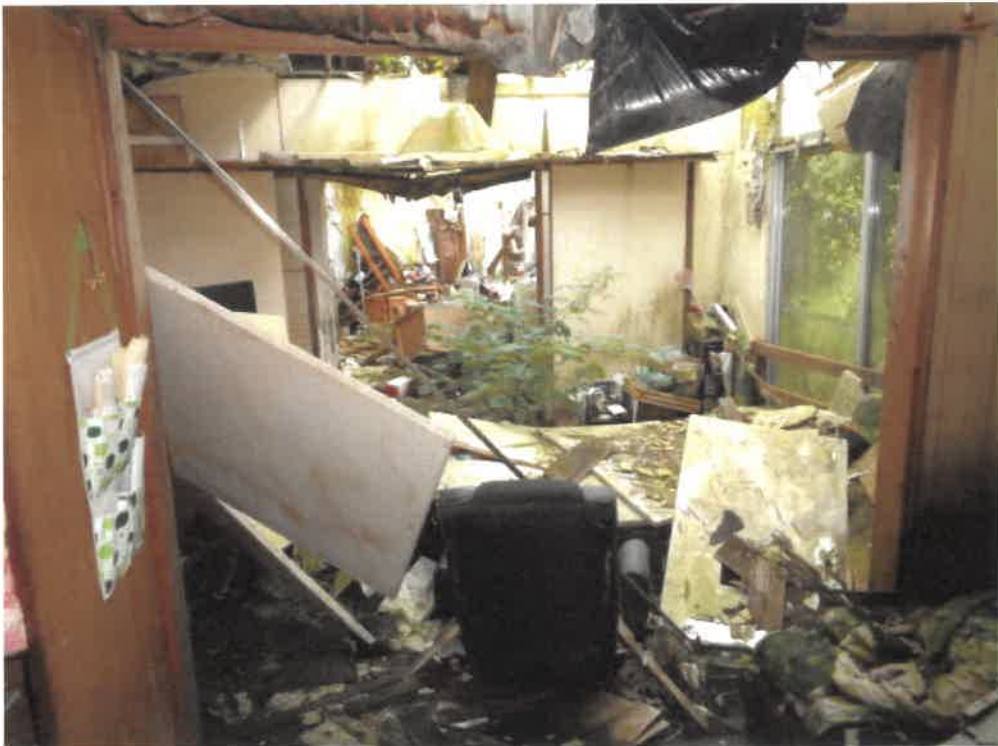
(写真8) 主たる建物内部 (2階：天井が抜けている)
