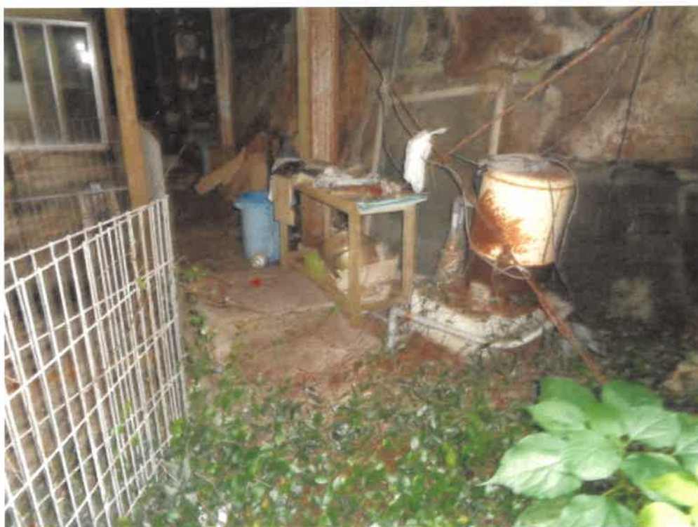
(写真4) ボーリング井戸 (主たる建物2階の下)
