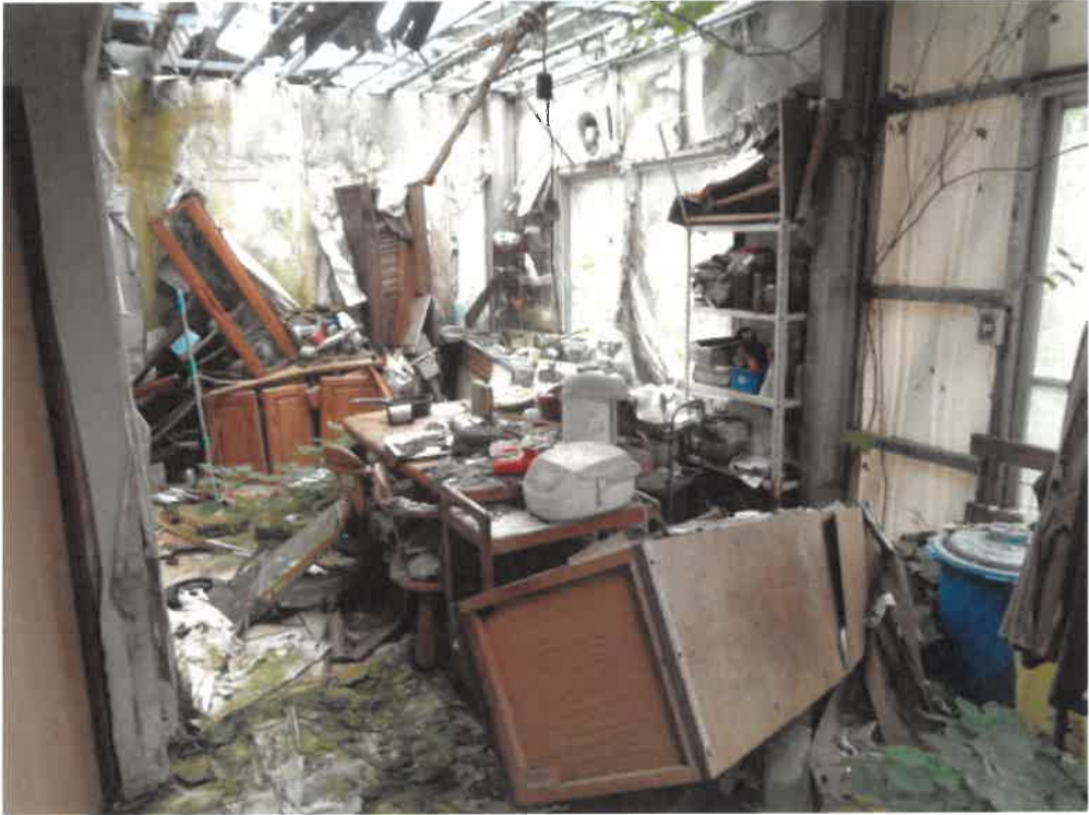
(写真9) 主たる建物内部 (2階: 天井が抜けている)
