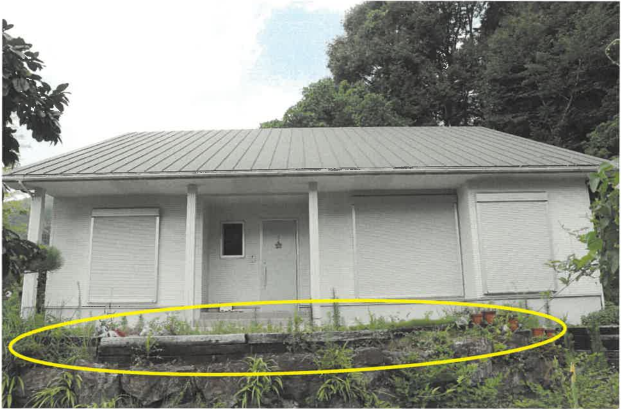
木製外構の老朽化
