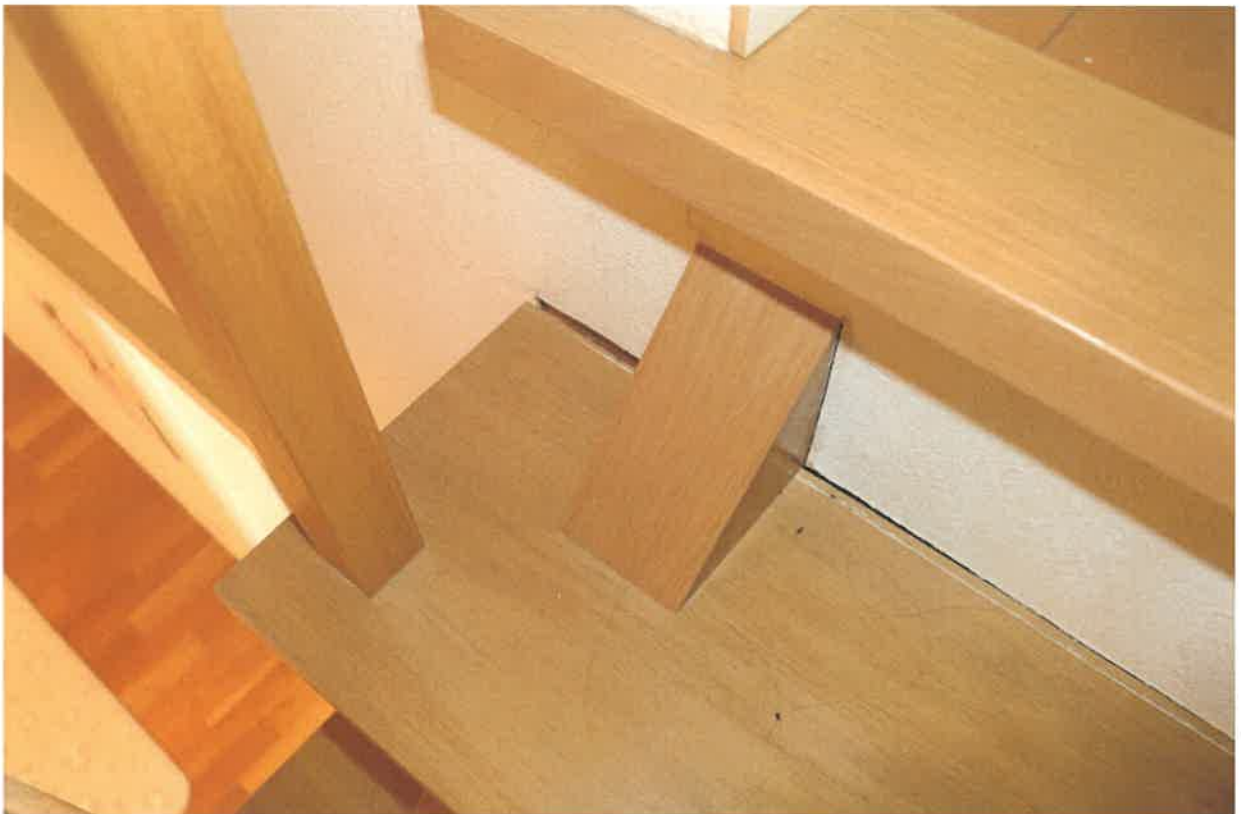
階段踏面の浮き
