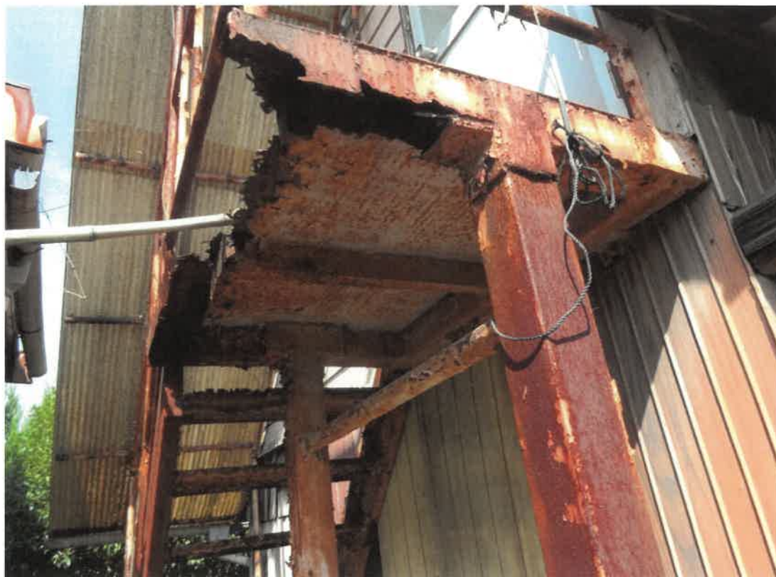
物件6（主である建物） 外階段の劣化の状態
