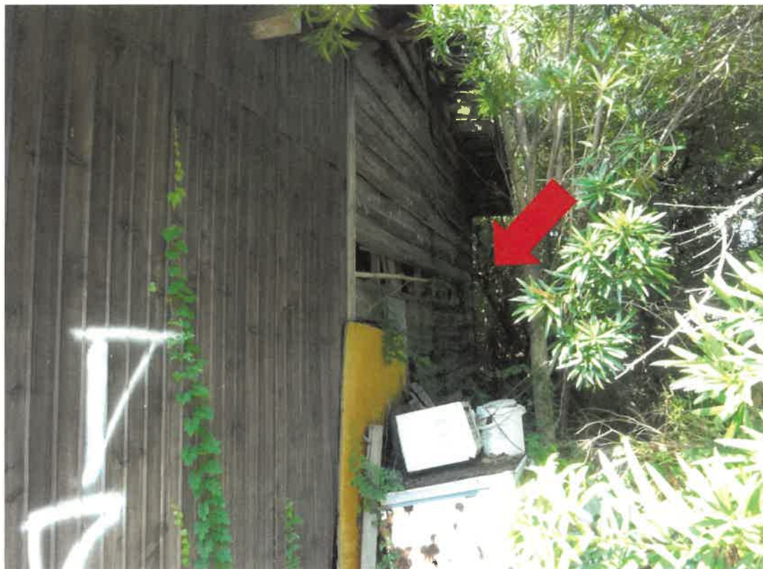
物件6（主である建物） 外壁の劣化の状態
