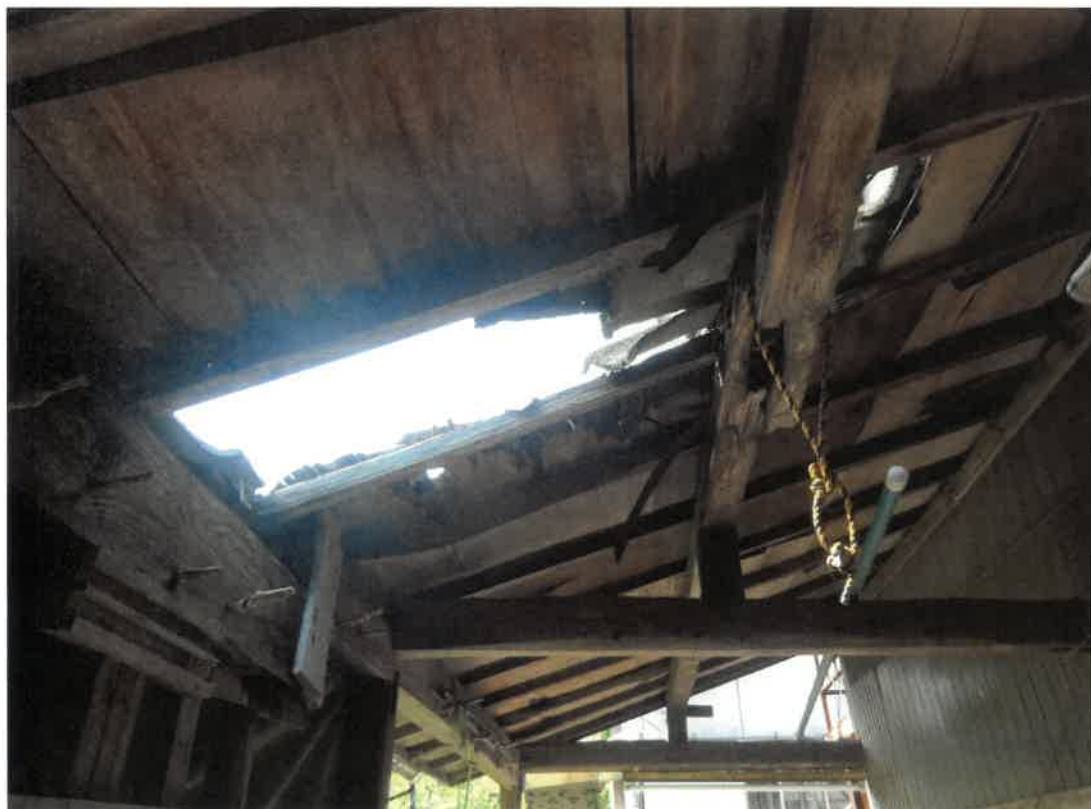
物件6（主である建物） 下屋の劣化の状態
