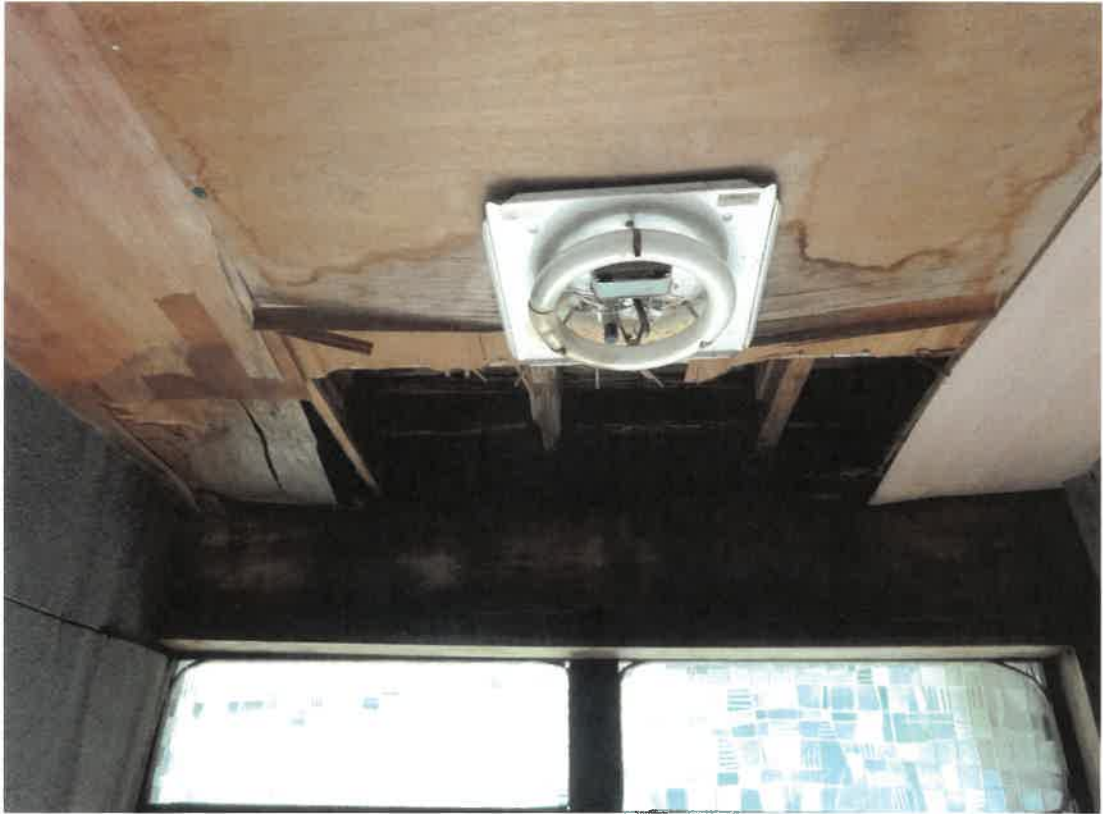
物件7（主である建物）内部 玄関天井の劣化の状態
