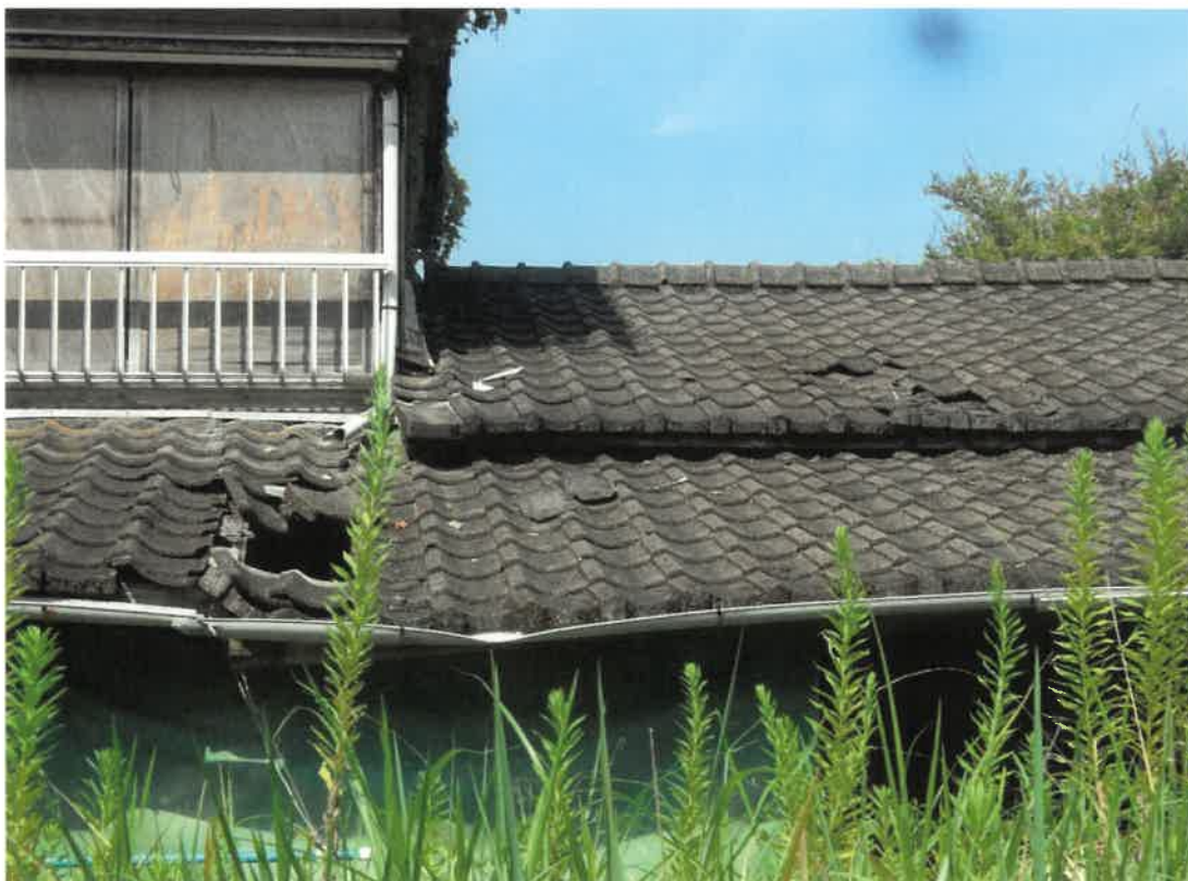
物件6（主である建物） 屋根瓦の劣化の状態
