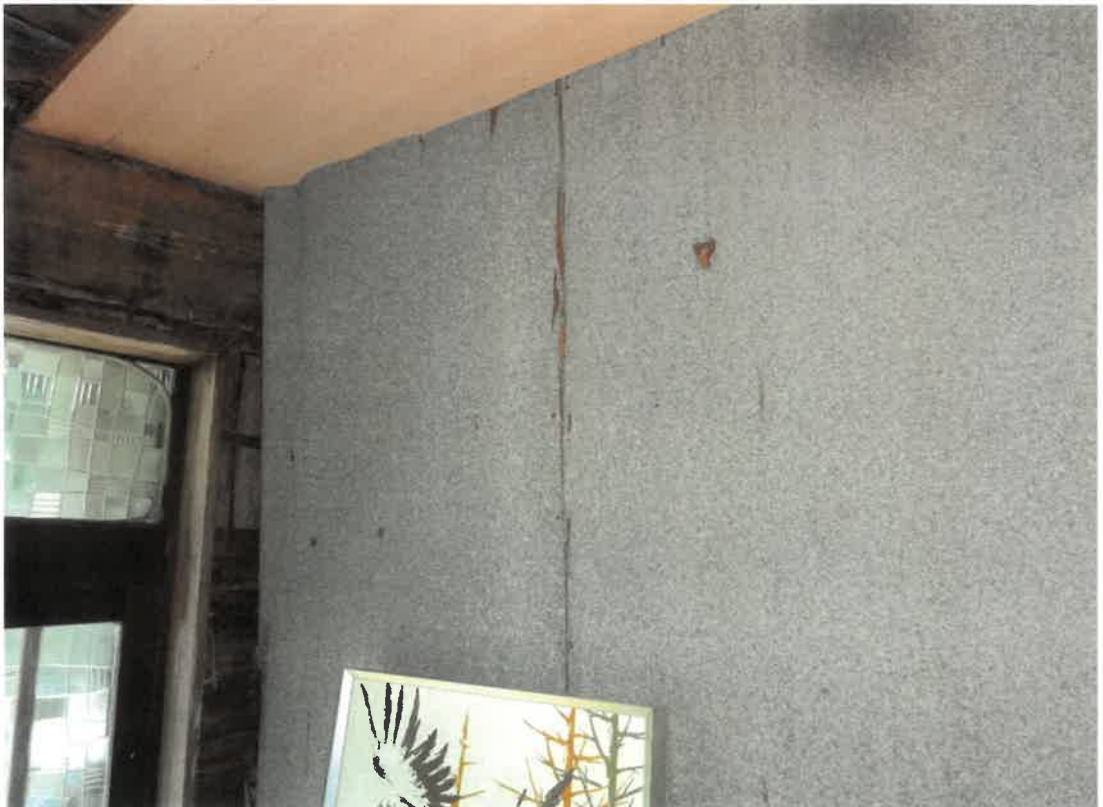
物件7（主である建物）内部 玄関内壁の劣化の状態
