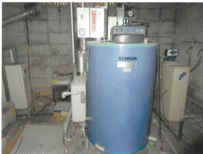
写真②⑤ボイラー
