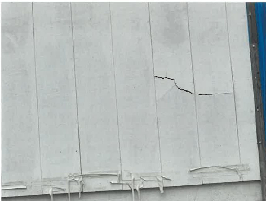
物件 5 汚損の状況 外壁の破損
