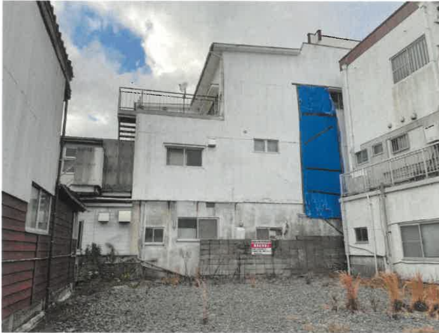
物件 5 汚損の状況 外壁の破損 (応急措置)
