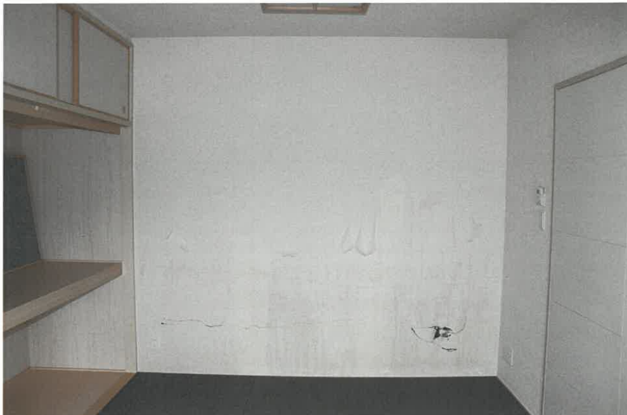
クロスの汚損・壁の損傷状況（和室）
