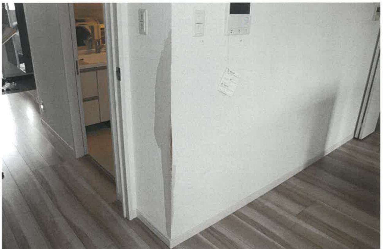
クロス損傷箇所 (LDK)
