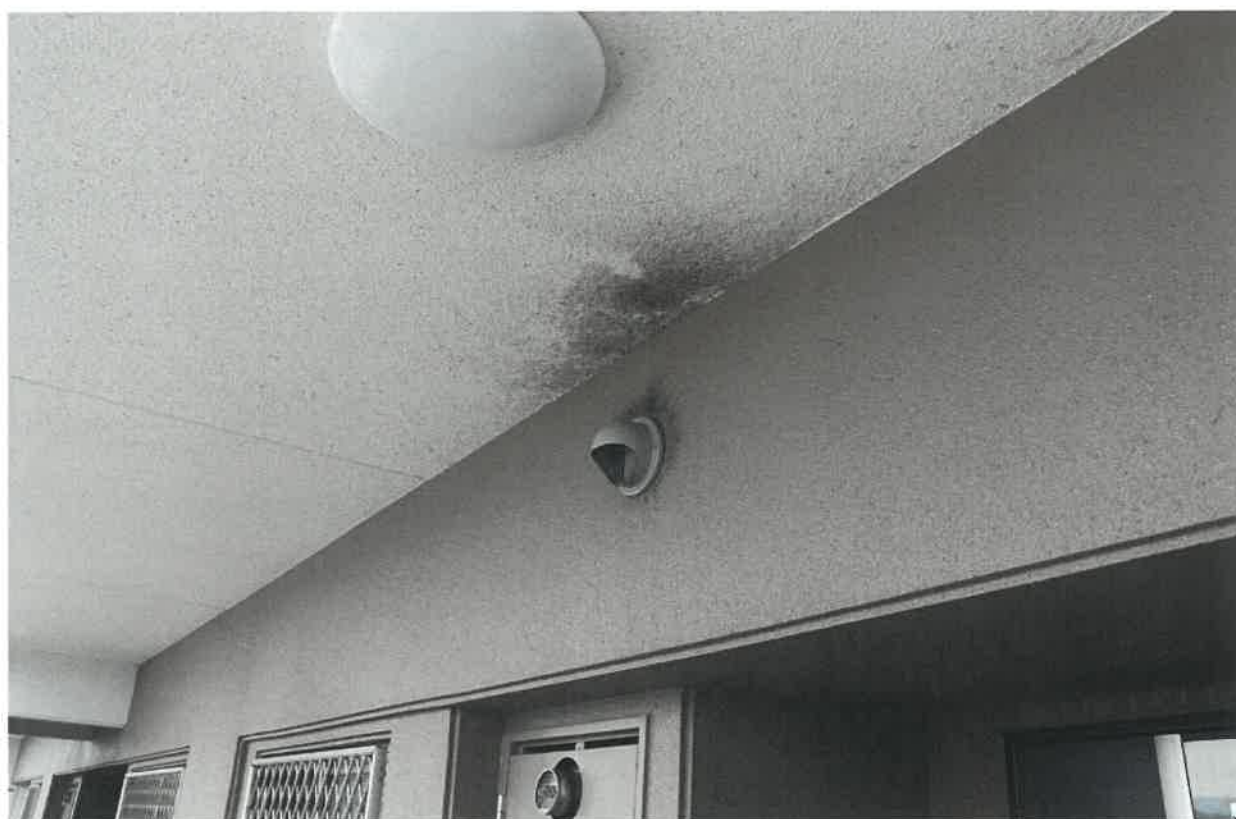
玄関前に設置された浴室換気口附近の壁汚損（共用部分）
