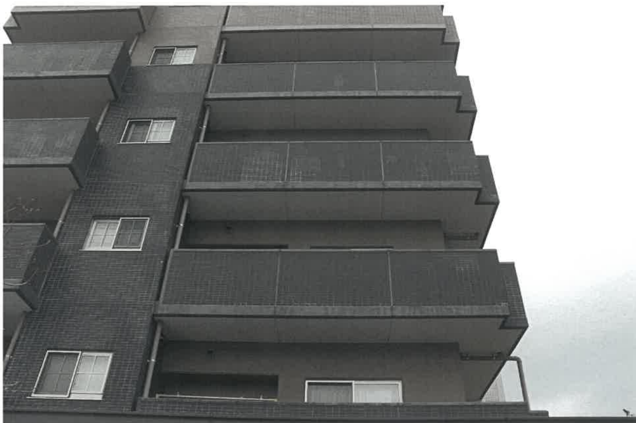
外壁タイルの施工不良・劣化状態（共用部分）
