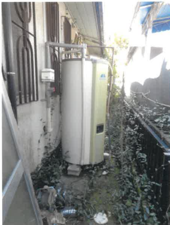
(写真5) 売却対象物件(建物の従物)である電気温水器
