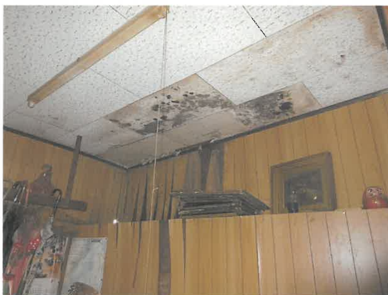
物件 6 天井の雨漏り・汚損
