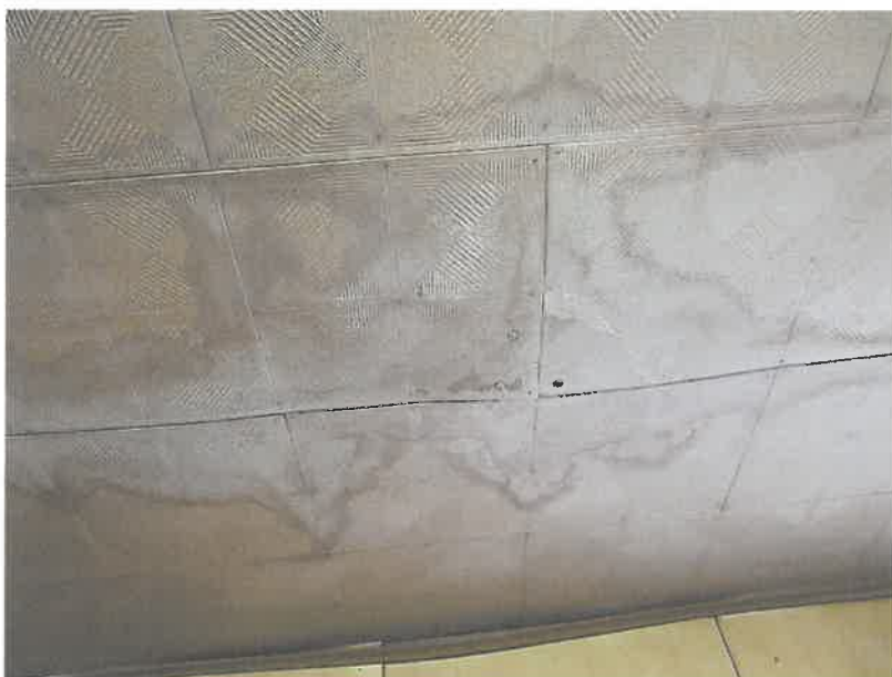
物件 6 天井の雨漏り
