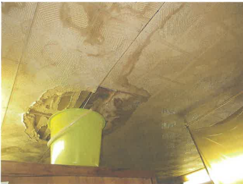
物件 6 天井の雨漏り
