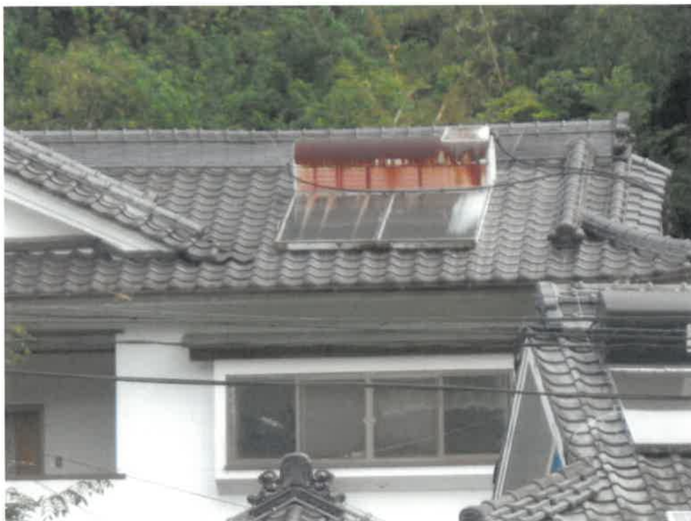
(写真2) 売却対象物件(従物)である太陽熱温水器
