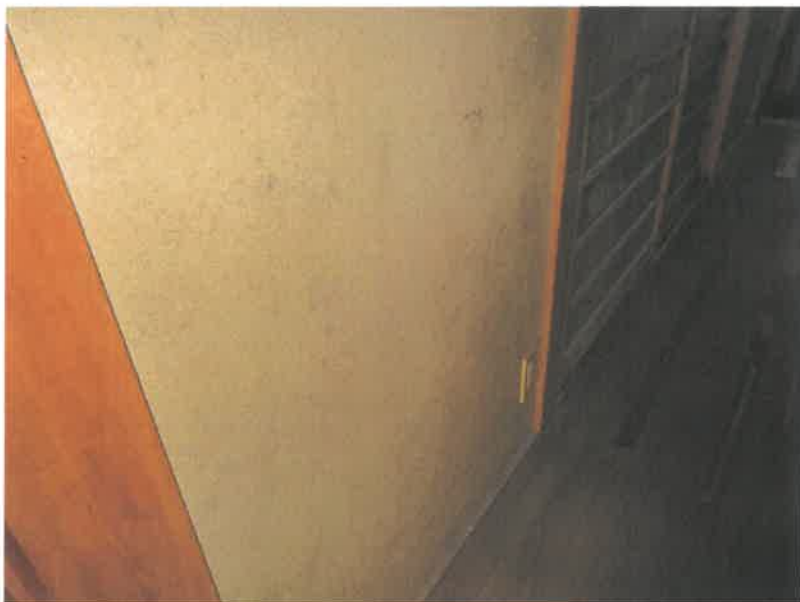
物件 3 壁の汚損
