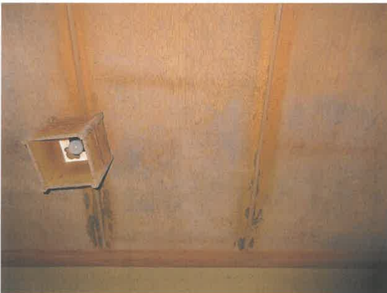
物件 3 天井の汚損
