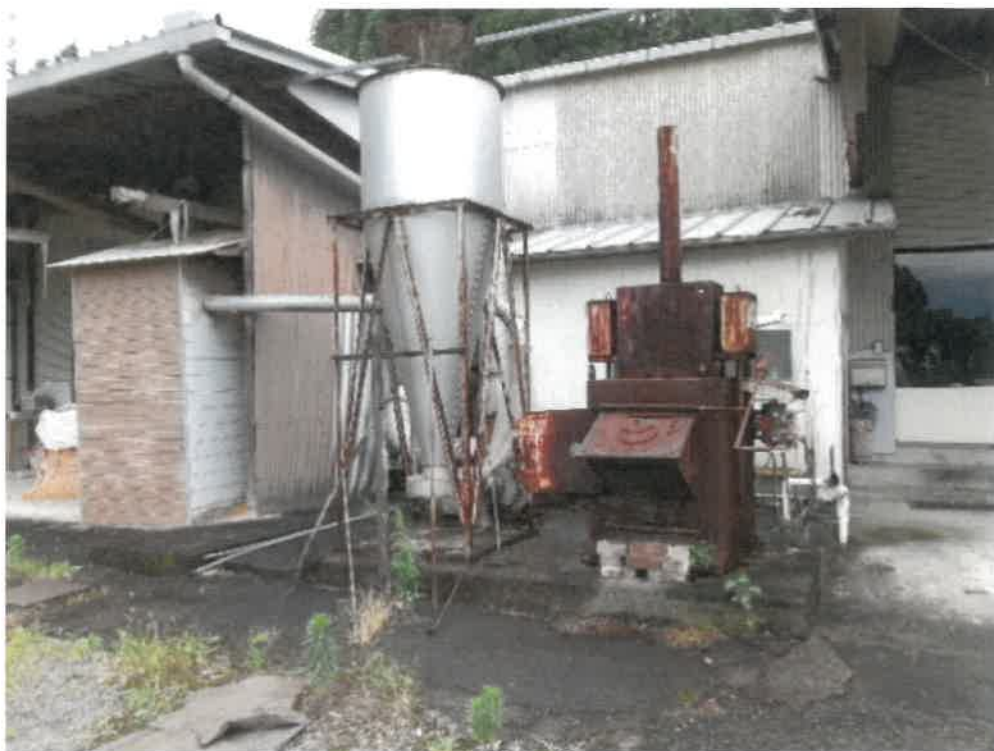
(写真 3 4) 送風集塵機 (機械器具目録 1 8 番) ・ 焼却炉 (機械器具目録 1 9 番)
