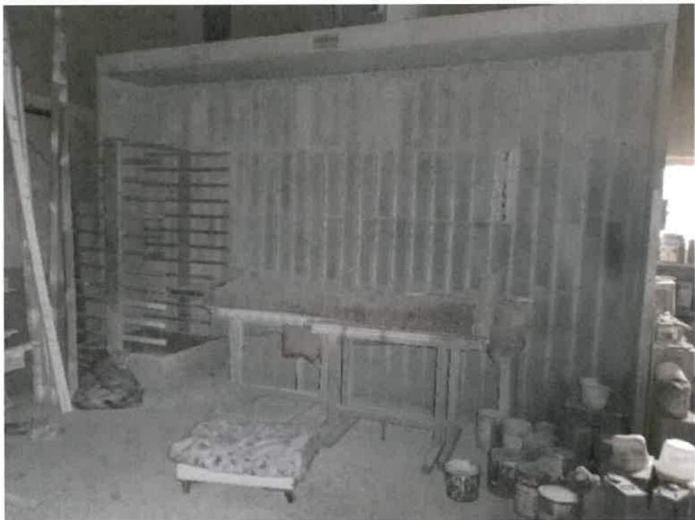
(写真 3 3) 塗装ガス吸引機 (機械器具目録 1 7 番)
