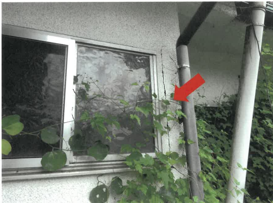
物件3（主である建物） 外壁のクラック
