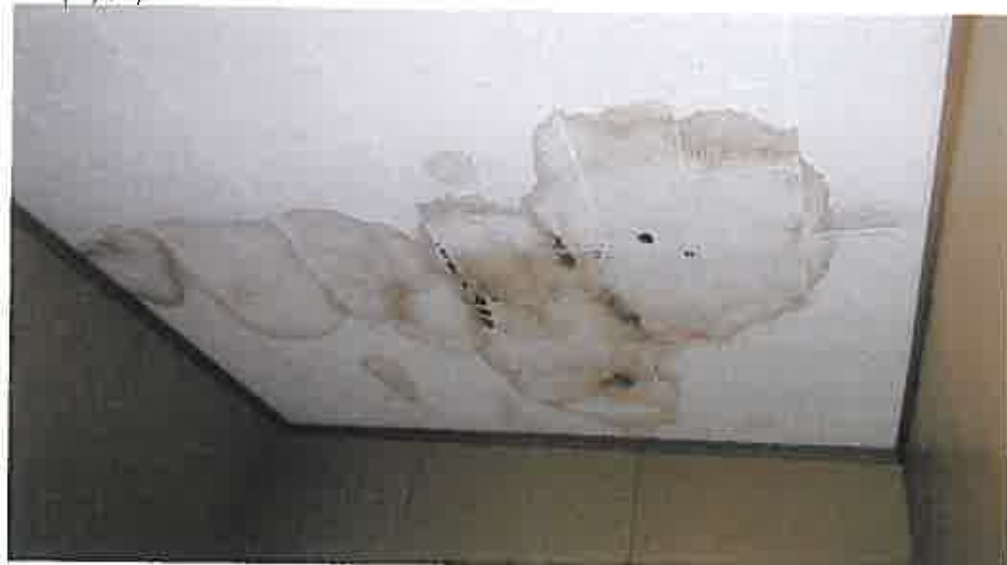
(写真 7 ) 雨漏り跡
