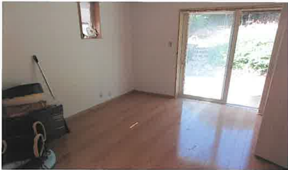
(写真17) 猫のひっかき傷跡(損傷部分)
