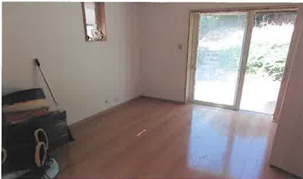
(写真17) 猫のひっかけ傷跡 (損傷部分)
