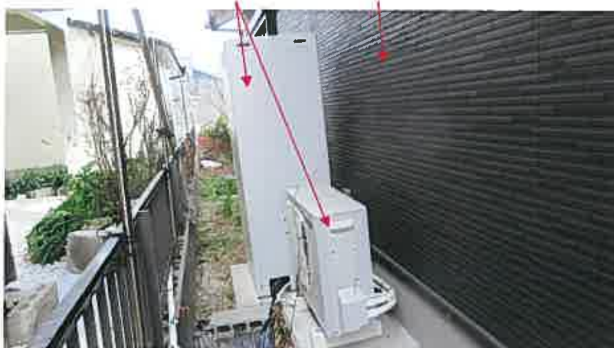
ヒートポンプ給湯機 物件 2
