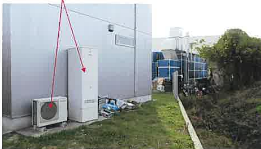
ヒートポンプ給湯機
