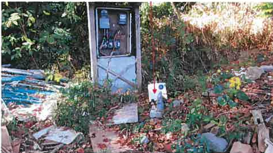
井戸・井戸ポンプ
