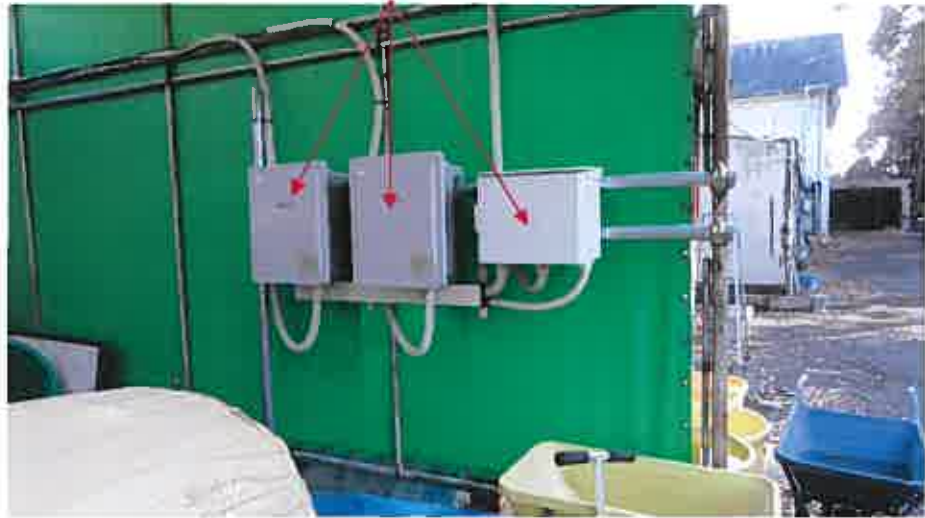
(写真 8 ) 同上 太陽光発電設備
