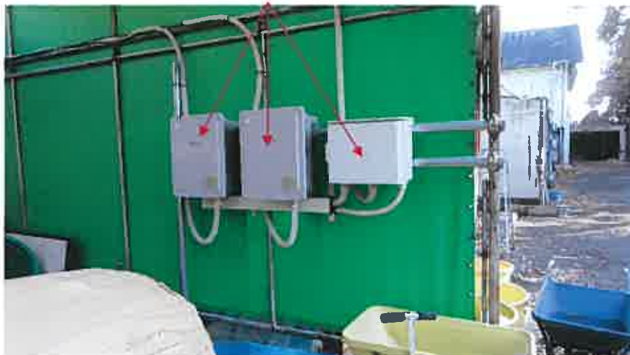
(写真 8 ) 同上 太陽光発電設備
