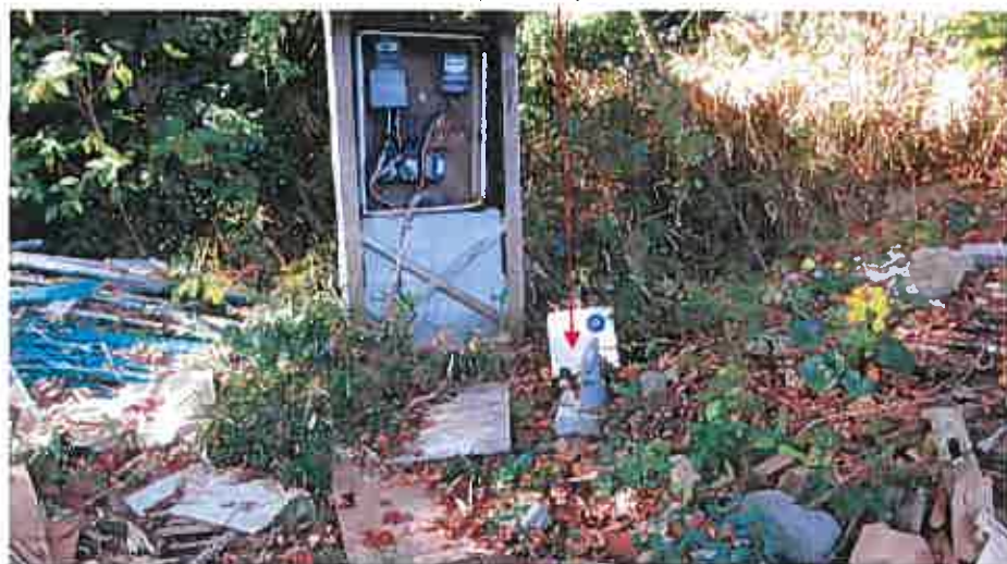
(写真 2 ) 井戸・井戸ポンプ
