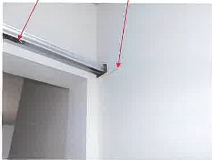
(写真 21 ) 吊戸部品破損 クラック
