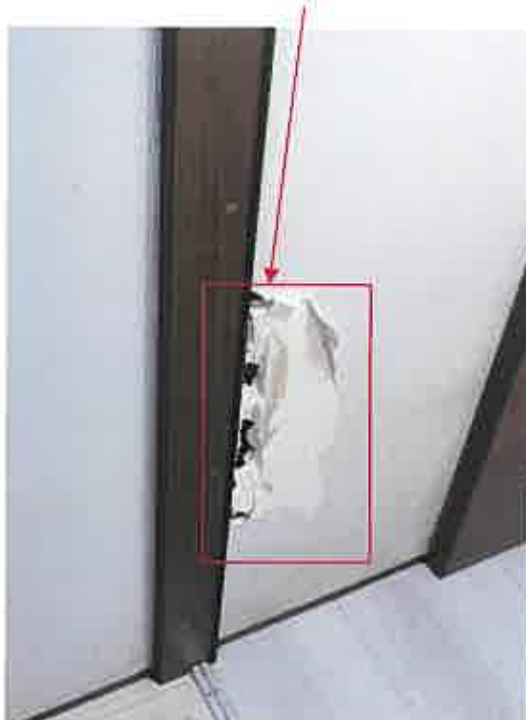
内壁の破損部分
