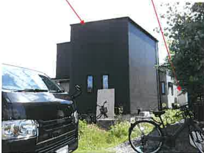
(写真 5 ) 物件2 (敷地が物件1) ヒートポンプ給湯機
