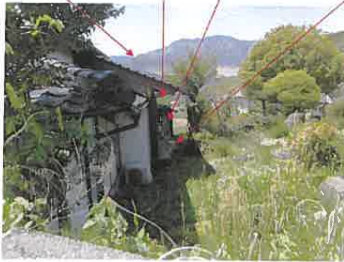
(写真7) 物件2 (主である建物) 下屋 ヒートポンプ給湯機 濡れ縁
