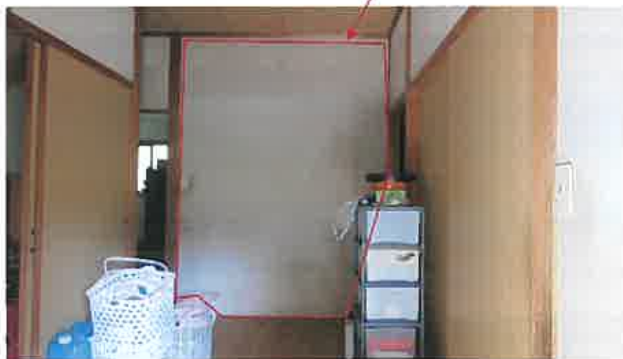
物件 2 建物内部 (写真 14 まで) 内壁の損傷
