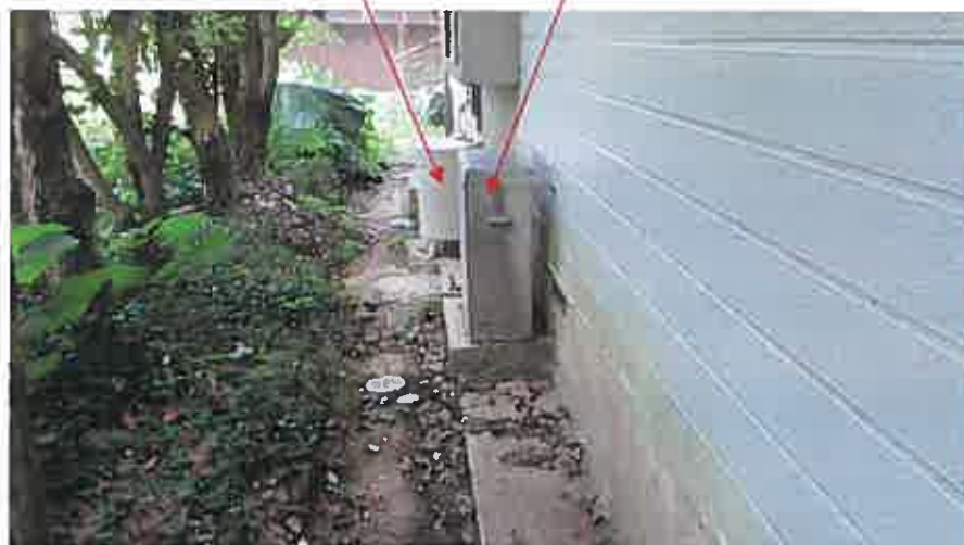
灯油タンク 灯油ボイラー
