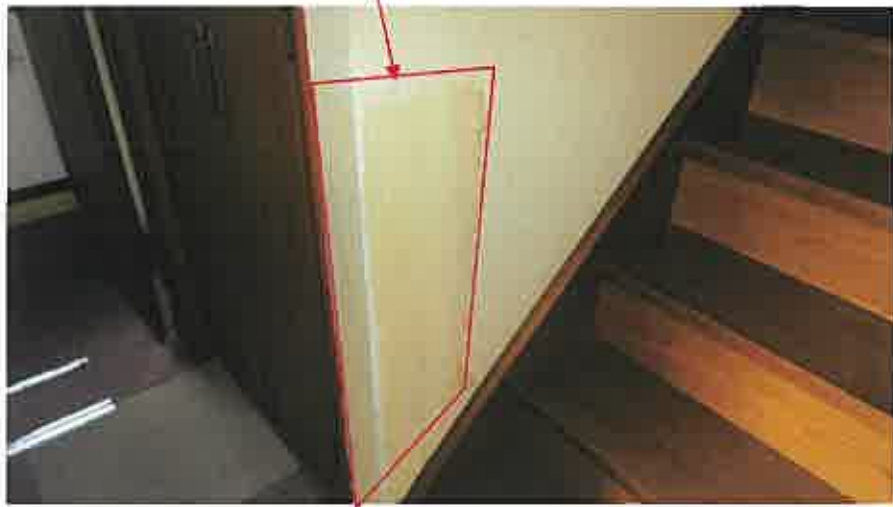
内壁クロスの損傷
