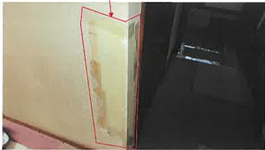
内壁クロスの損傷
