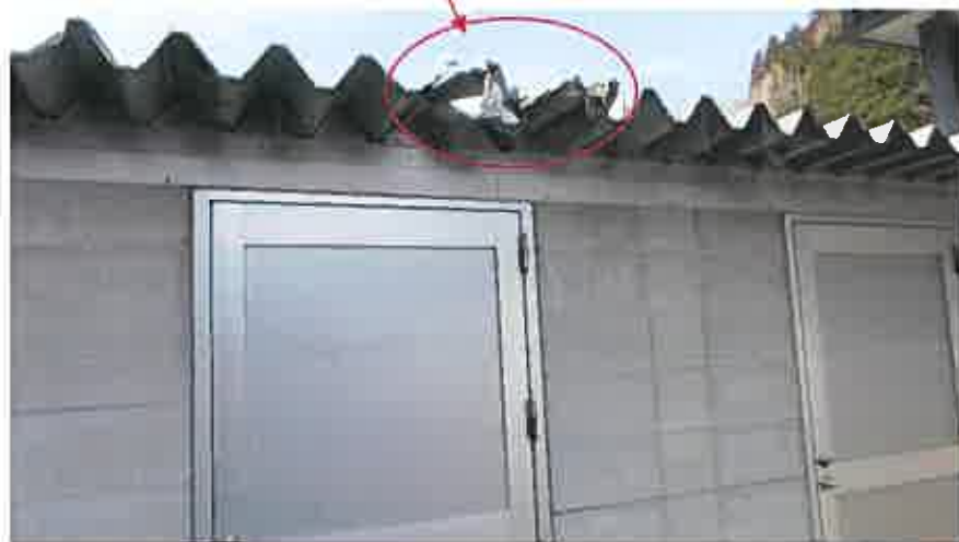
屋根の一部損傷
