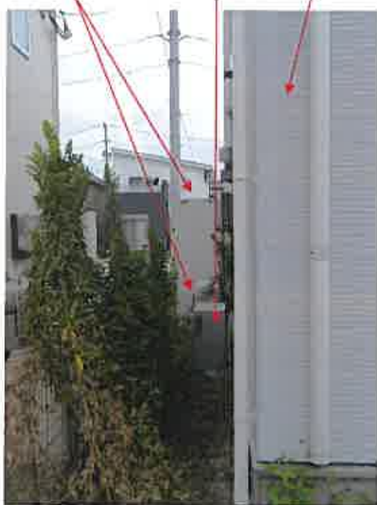
(写真 4 ) ヒートポンプ給湯機 蓄電池 物件 2 (敷地が物件 1)
