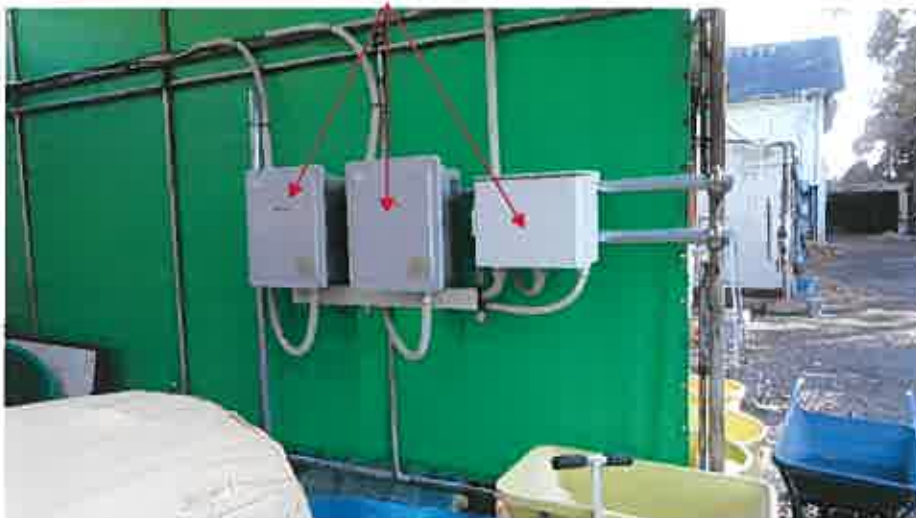
(写真 8 ) 同上 太陽光発電設備
