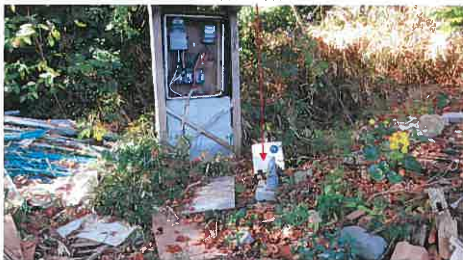
(写真 2 ) 井戸・井戸ポンプ
