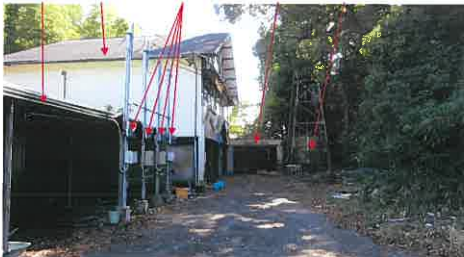
(写真 1 ) 物件 27 物件 25 太陽光発電設備 物件 26 貯水タンク
