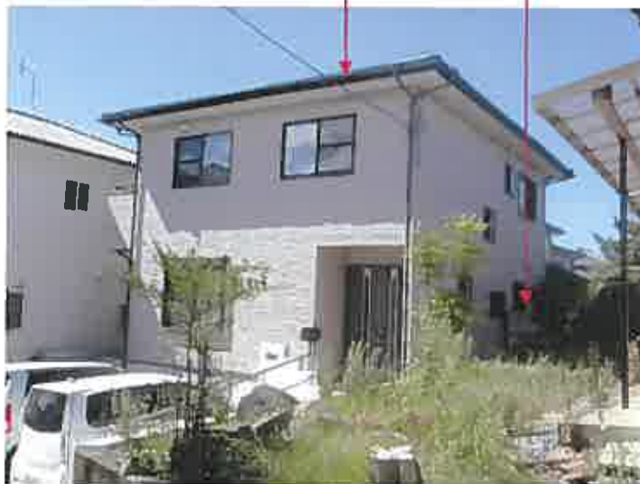
物件 2 (敷地が物件 1) ヒートポンプ給湯機
