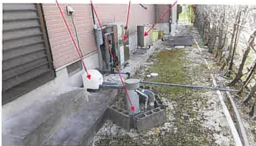
井戸ポンプ 井戸 石油給湯器 灯油タンク
