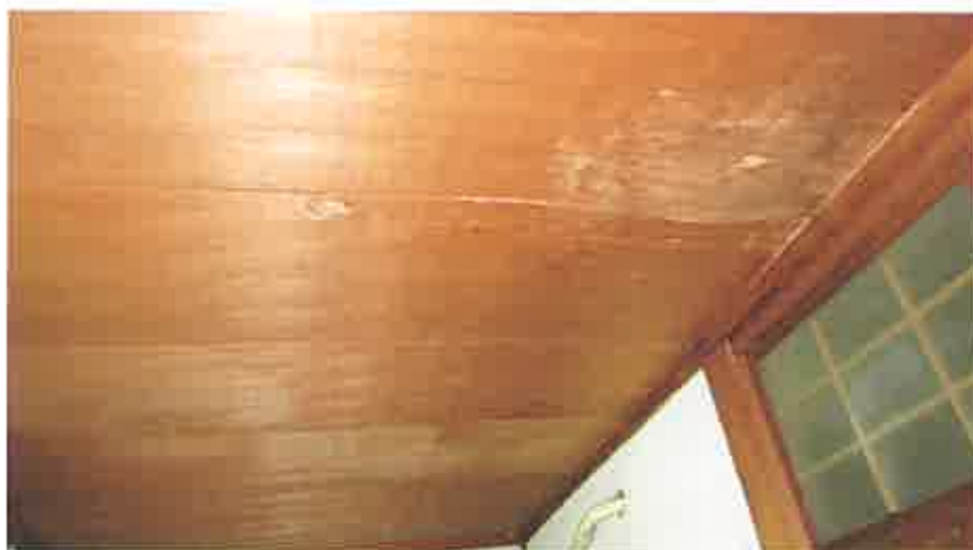
天井の損傷状況
