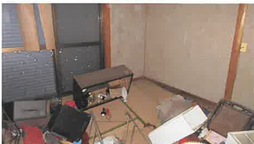
床の脱落状況
