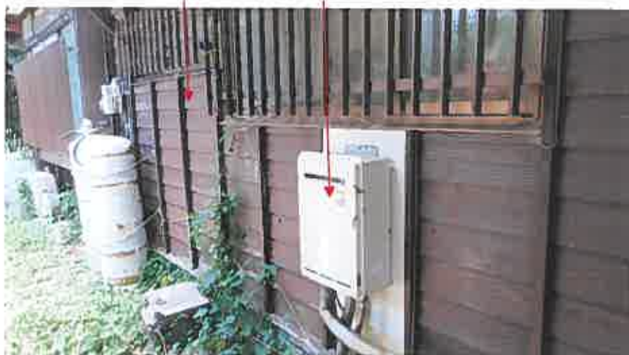
物件 2 の居宅 ガス給湯器
