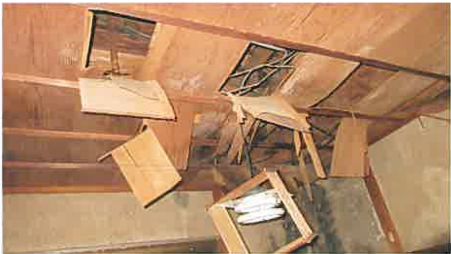
天井の損傷状況
