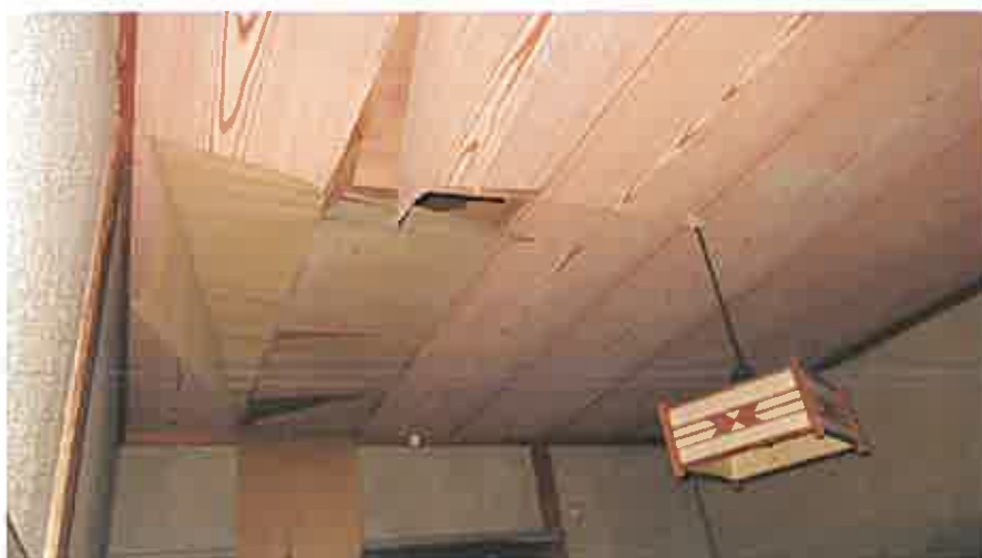
天井の損傷状況
