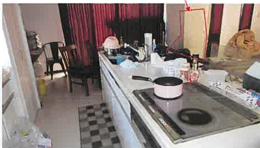
内壁クロスの損傷
