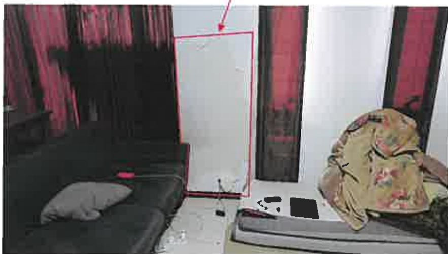
内壁クロスの損傷
