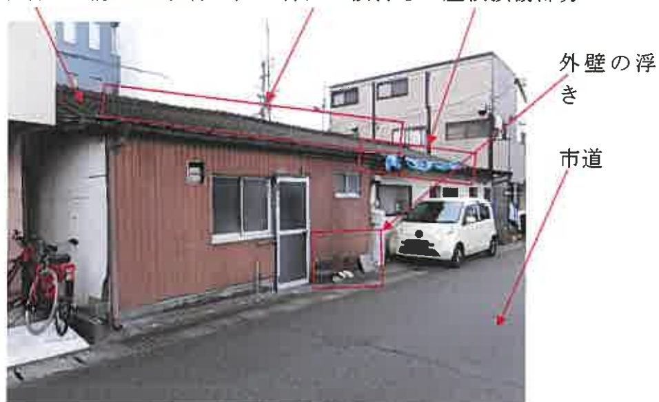
(写真 9 ) 屋根損傷部分 棟瓦の波打ち 物件 2 (敷地が物件 1)
