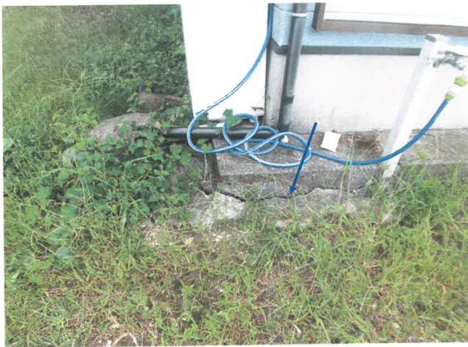
基礎のひびの様子
