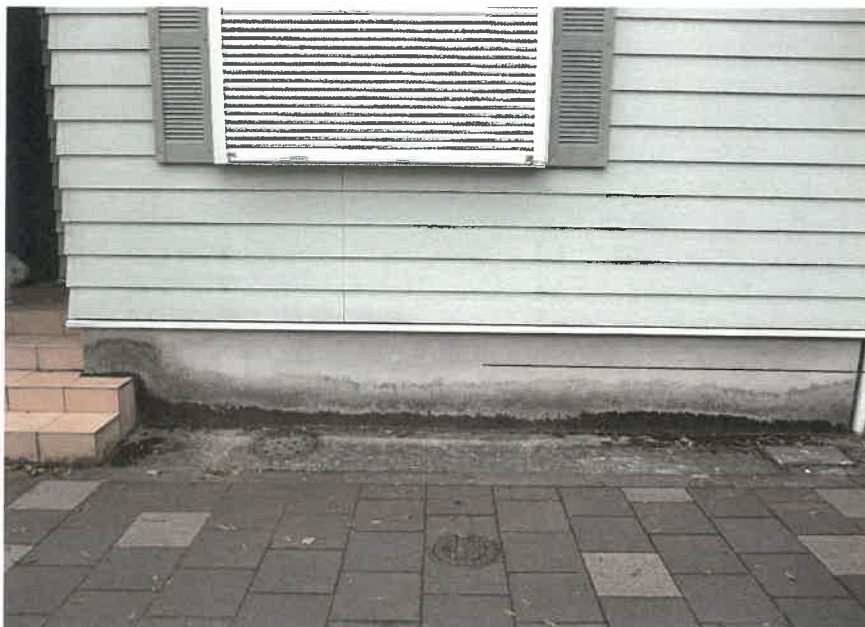
③建物基礎部分ひび(東)
