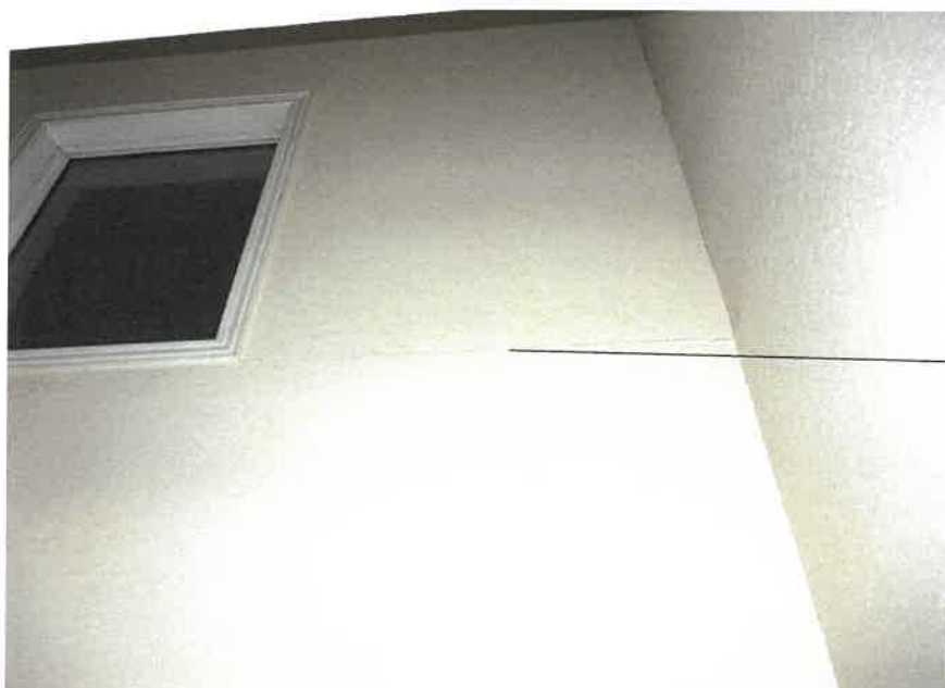
⑧ 内壁クロス亀裂 (1階階段付近)
