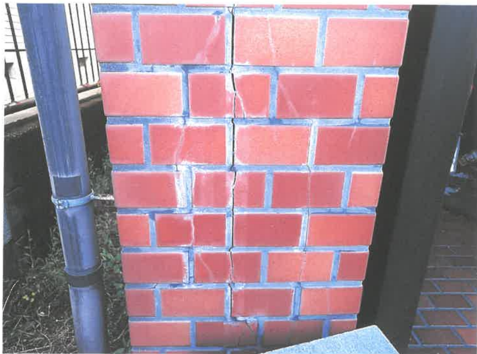
外壁の亀裂箇所
