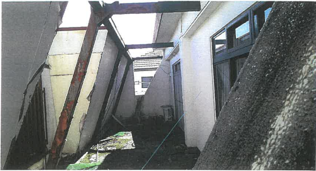
物件 2 2 階ベランダ状況
