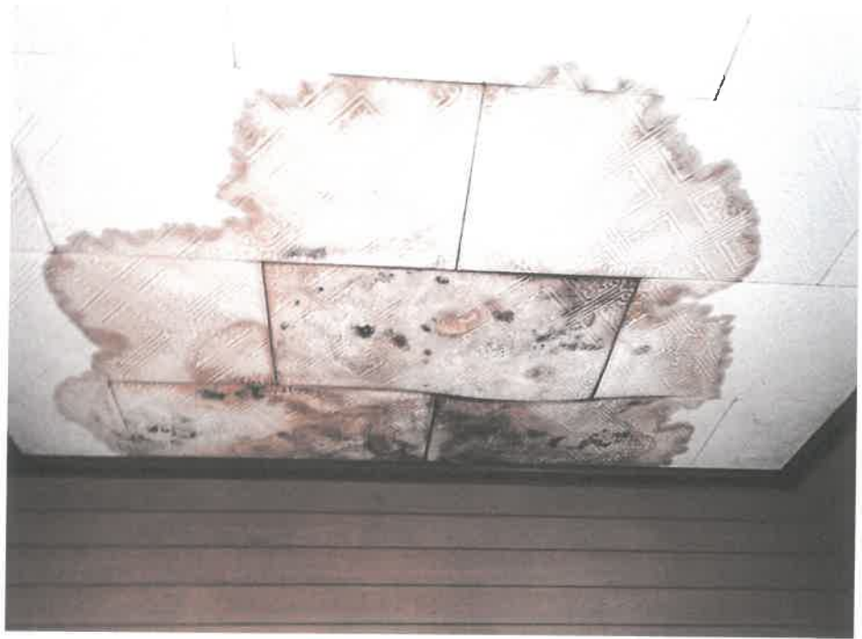
雨漏りの状況
