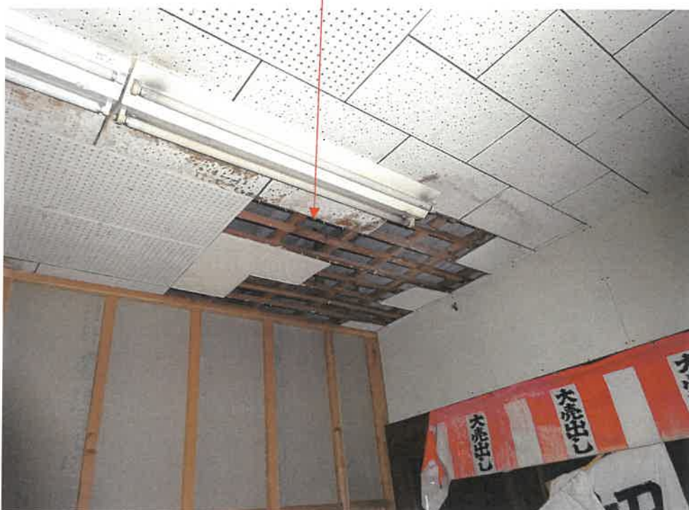
天井材の損傷
