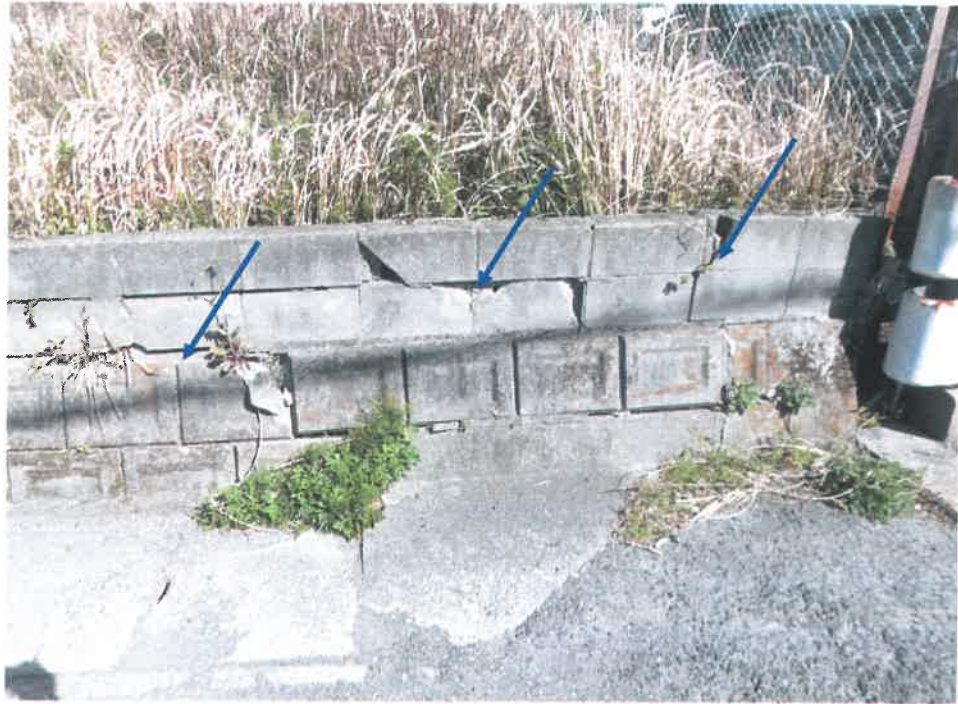
ブロックのひび割れの様子
