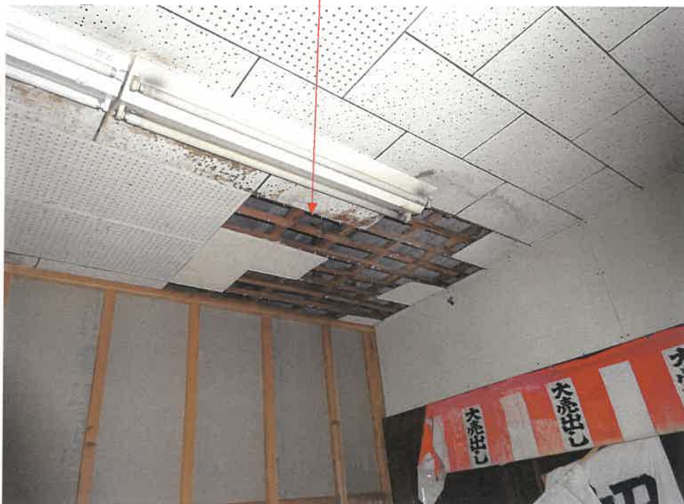
天井材の損傷
