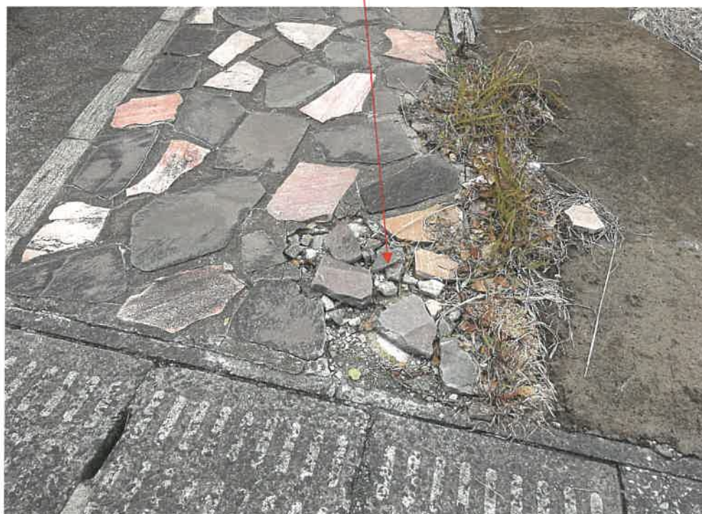
玄関アプローチの敷石の破損
