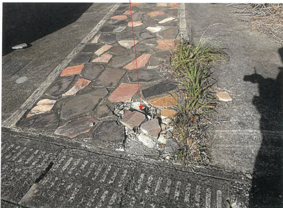
玄関アプローチの敷石の破損
