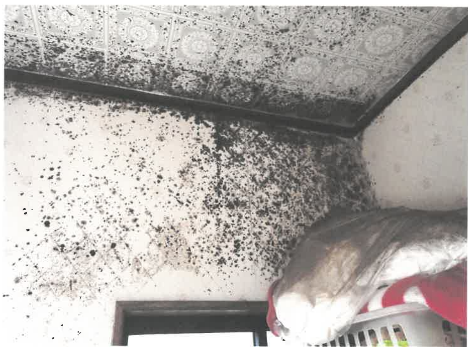
物件6 カビの発生状況
