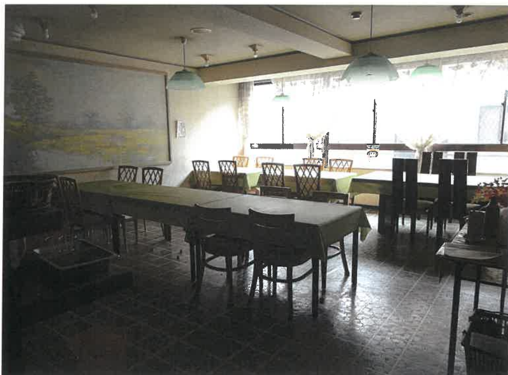
写真24 2階食堂内の壁クロスの傷み
