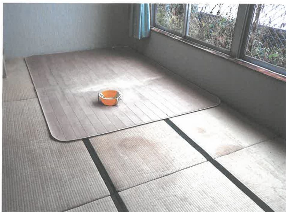
物件4 雨漏りの状況
