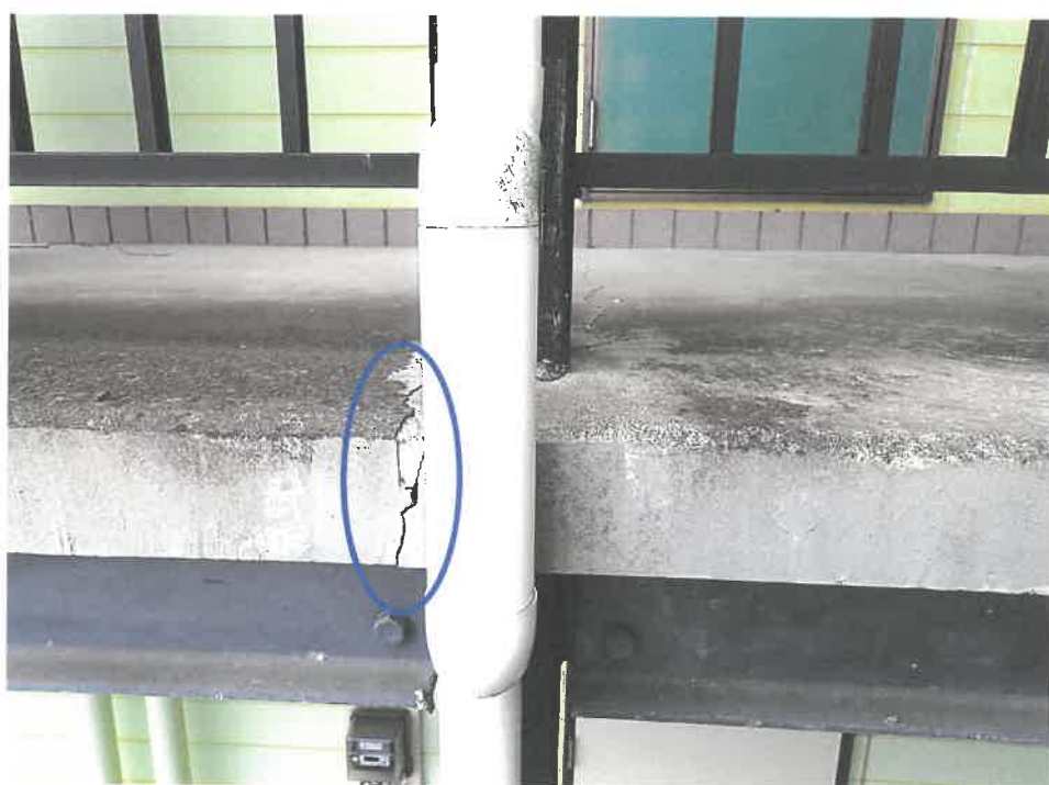
外階段のひび割れ
