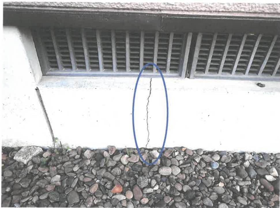
物件 8 建物基礎部分の亀裂
