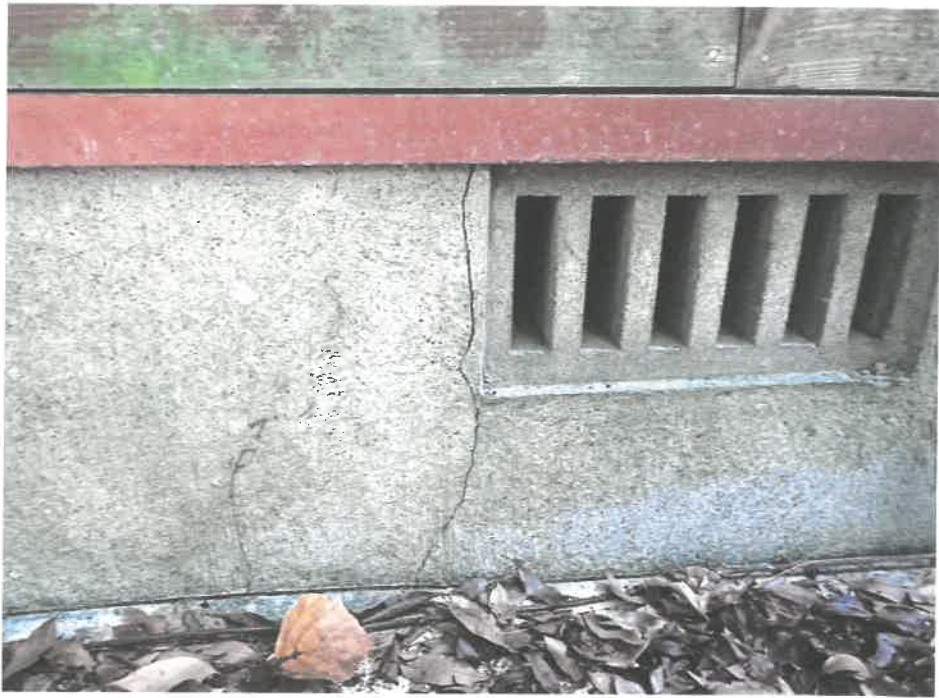
基礎の亀裂箇所
