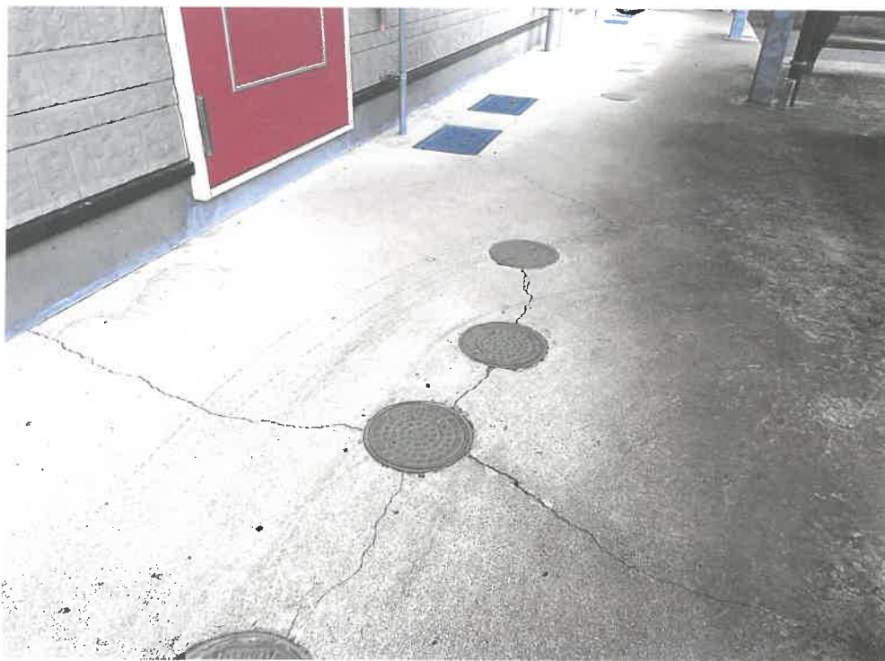
コンクリート部分のひび割れ
