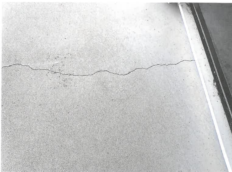
外階段のひび割れ
