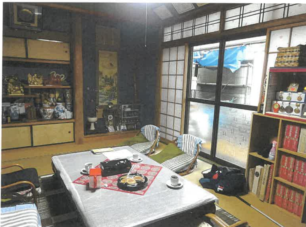
写真6 床の沈み込みを感じた箇所
