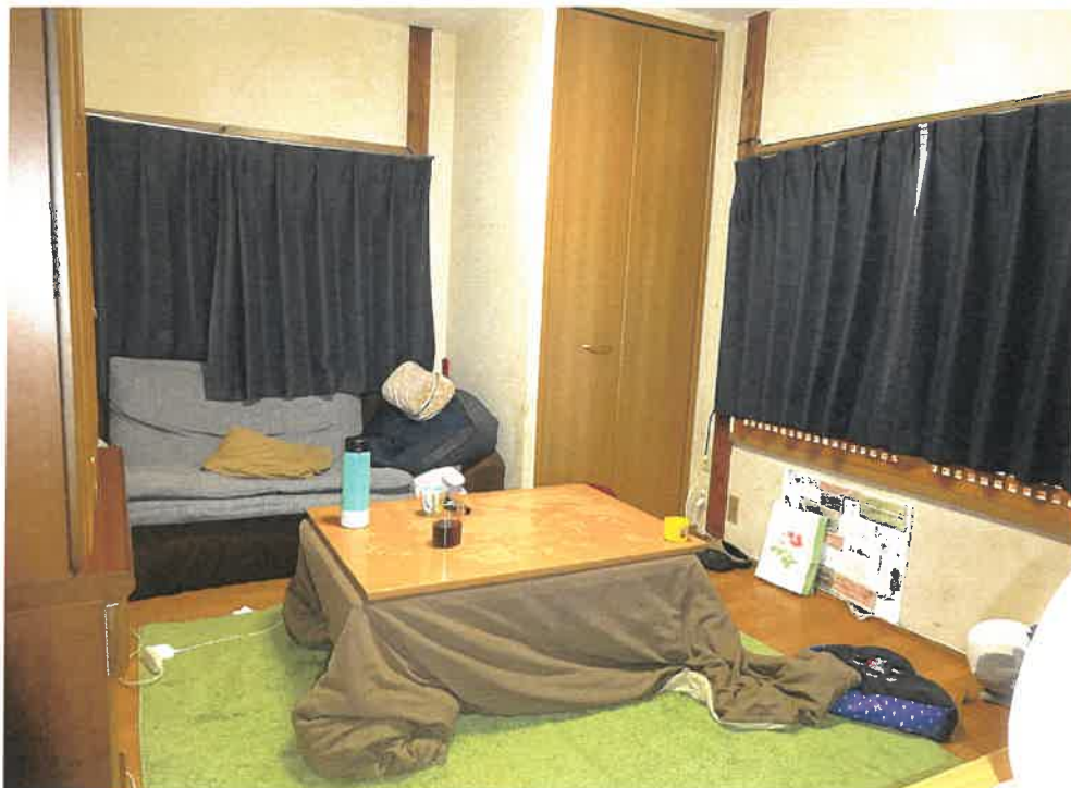
写真12 クロスの傷み
