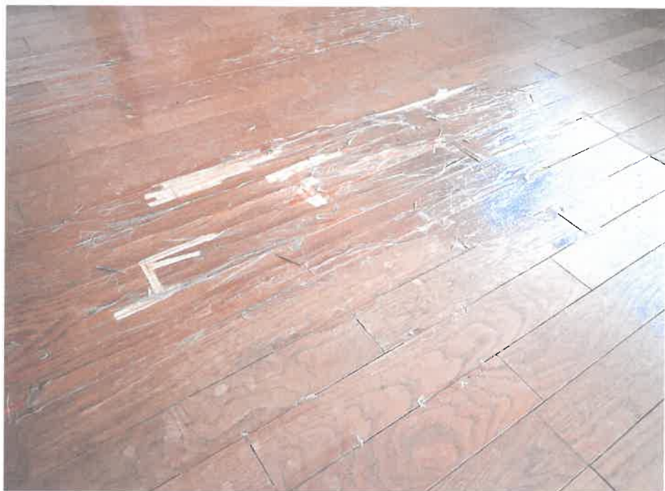
フローリングが傷んでいる箇所
