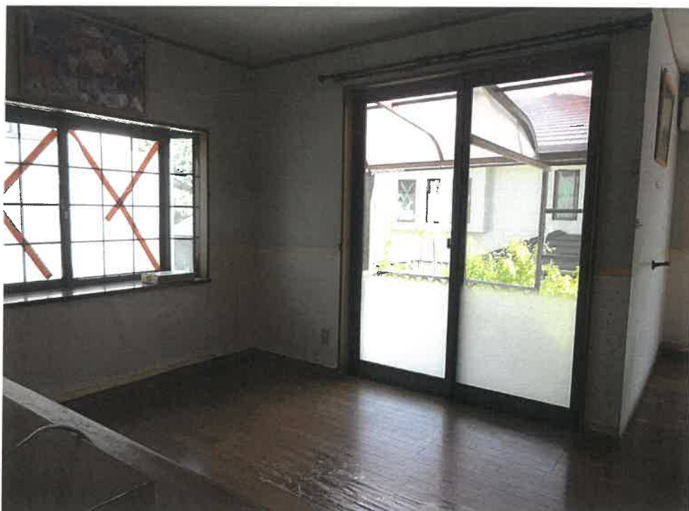
写真4 フローリングの傷み
