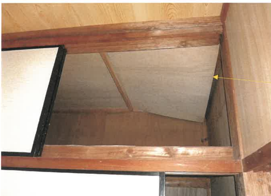
⑨物件 2 押入れ天井
