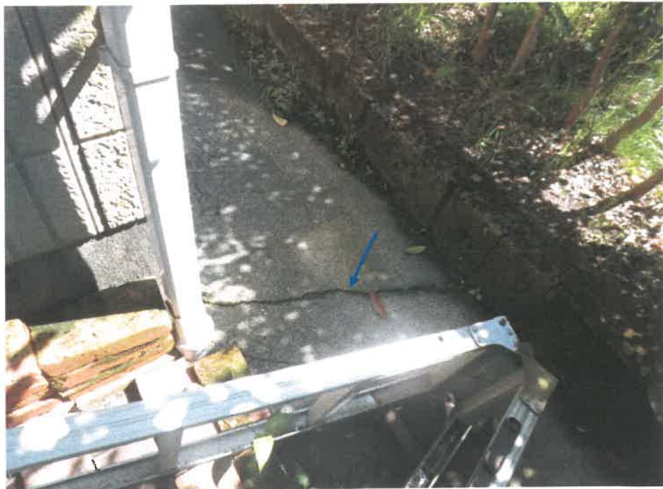
犬走りの亀裂の様子
