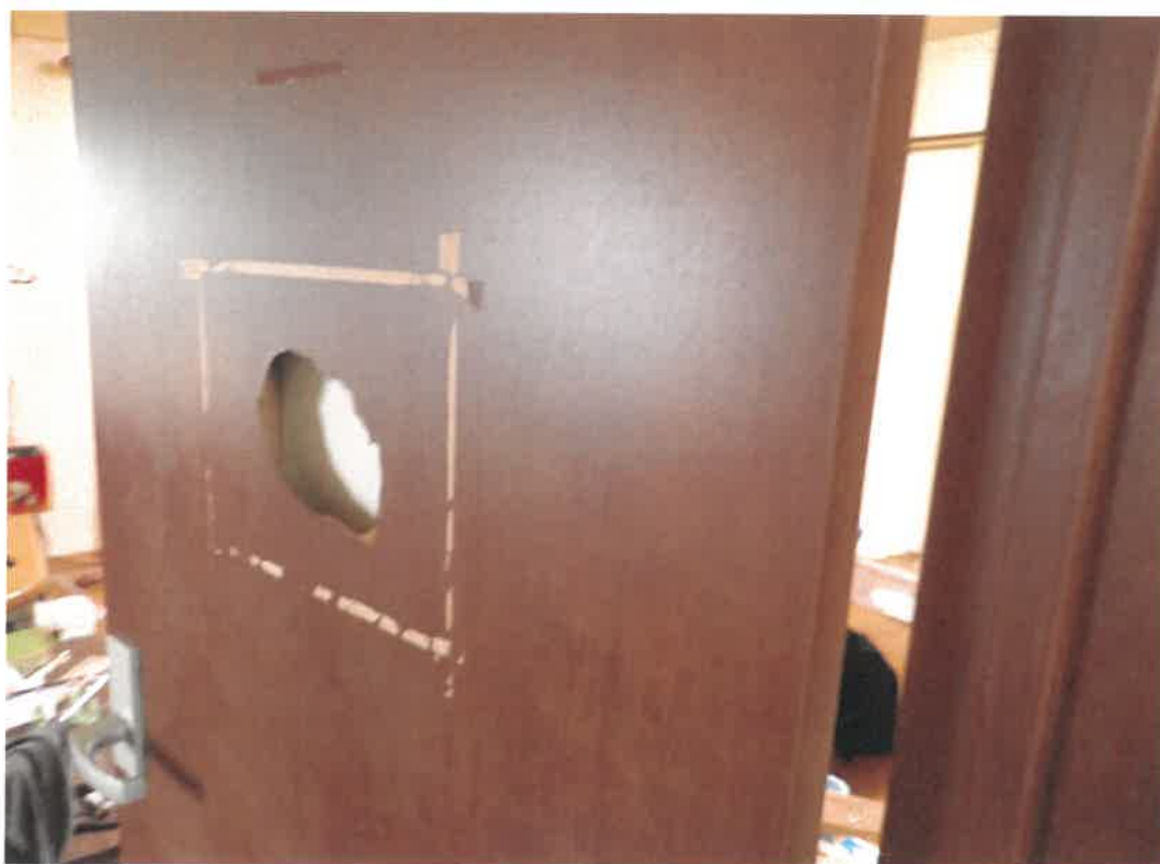
写真 ④ 建具の損傷
