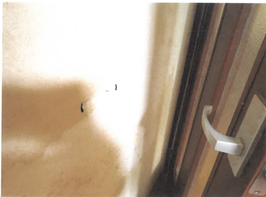
写真 ③ 内壁の損傷
